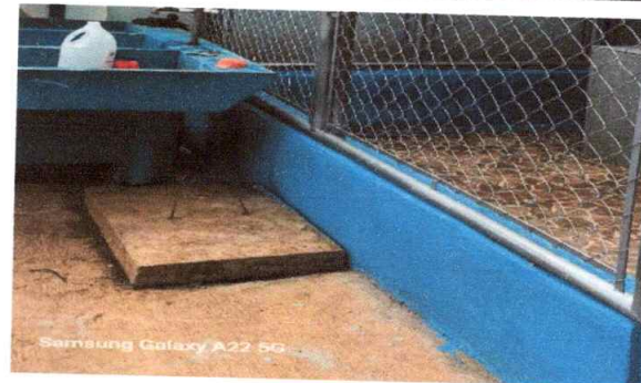
Foto 14: Mejoramiento de cernido para la circulación multichorro
