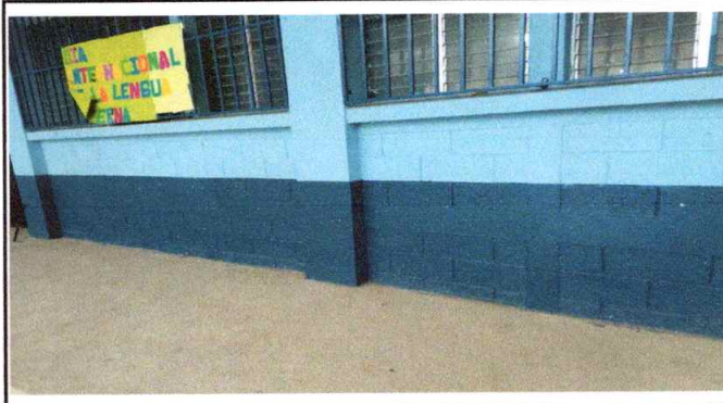
Foto 4: Sustrucción de pintura en las paredes de las aulas
