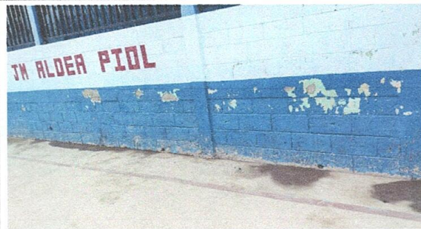
Foto 8: Pintra deteriorado en la pared exterior
