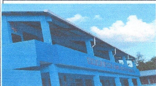
Foto 3: Los canales y bajadas de las aguas pluviales están deterioradas.
