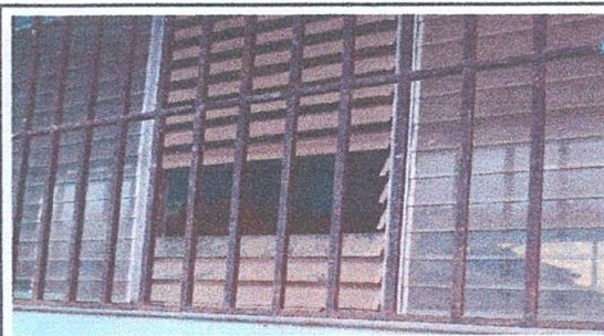
Foto 10: Los vidrios de las ventanas están quebrados en su mayoría
