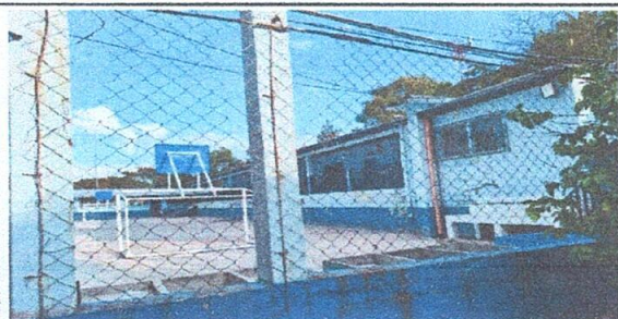
Foto 1: La malla galvanizada de la circulación esta deteriorada por oxido.
