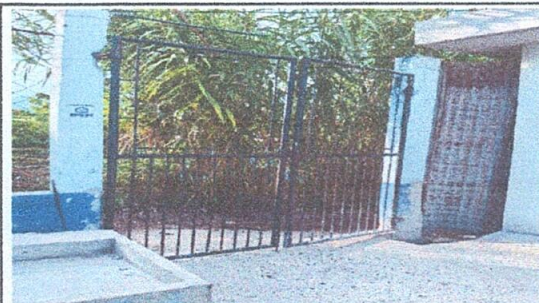
Foto 2: El portón principal del ingreso de la comunidad educativa esta deteriorada por el uso.
