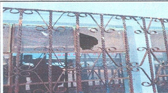
Foto 8: Balcones deteriorados por óxido y por varios años de uso
