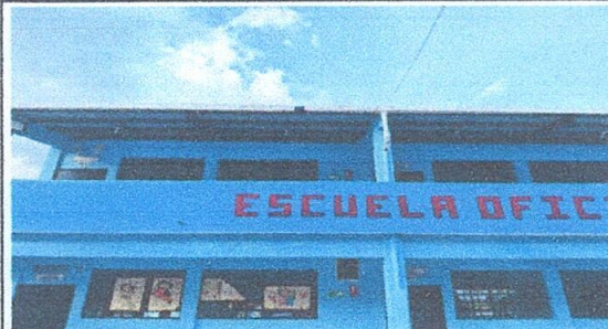
Foto 4: Varios canales de PVC están en malas condiciones.
