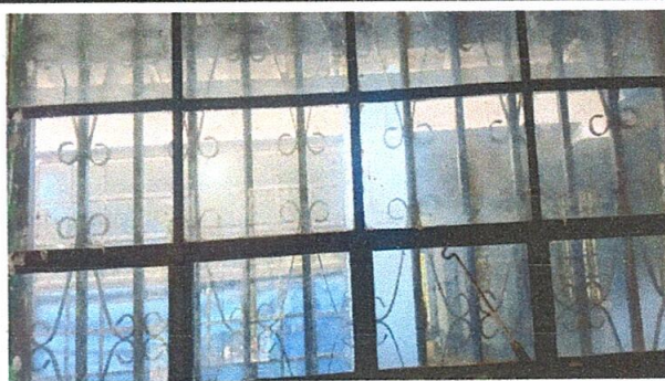
Foto 4: Sustrucción de vidrios
