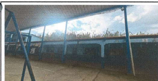
Foto 17: Canales de bajadas de agua en mal estado
