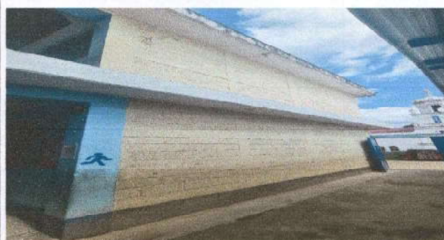
Foto 4: Pared necesita pintura nueva.
