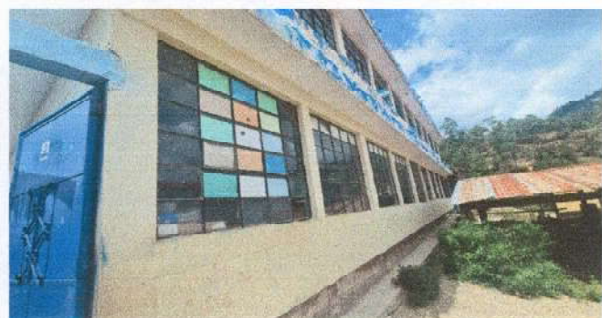
Foto 3: Ventanas necesitan balcones para una mejor protección.
