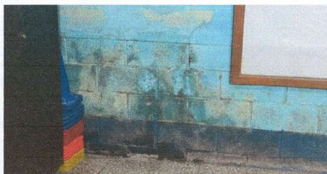
Foto 6: Pared necesita repello y pintura nueva.
