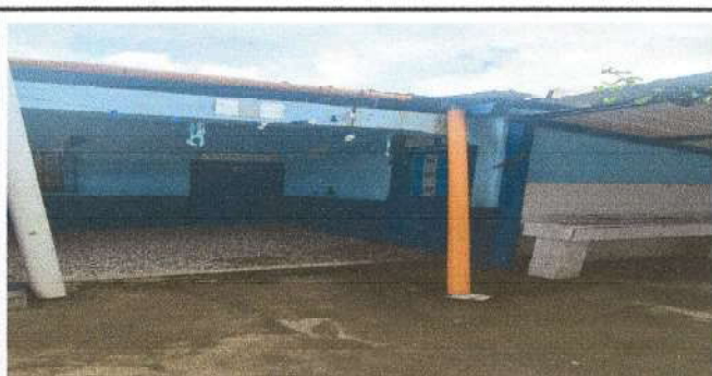
Foto 18: Tuvos de bajadas de agua en mal estado
