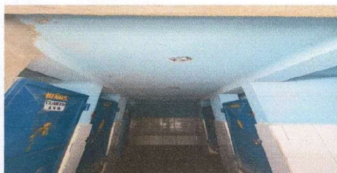
Foto 8: Servicio sanitario sin luz
