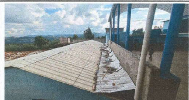
Foto 16: Laminas en mal estado
