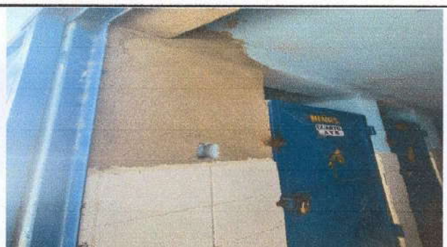
Foto 9: Baño sin luz eléctrica
