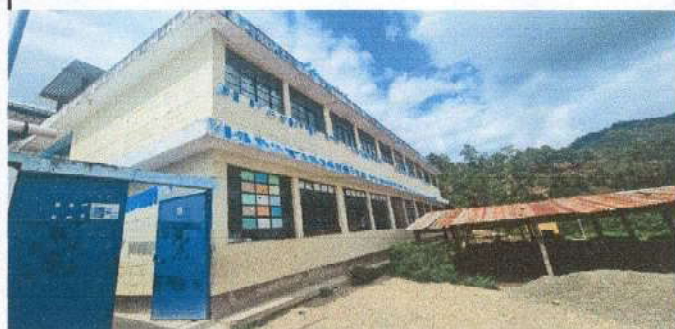
Foto1: Pared de edificio en malas condiciones
