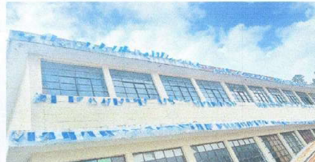
Foto 2: Pared necesita pintura nueva.
