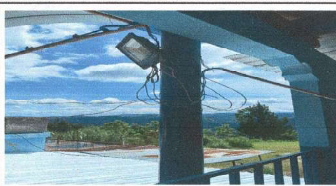
Foto 14: Lamparas en mal estado
