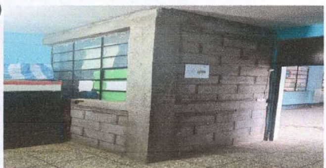
Foto 5: Pared necesita repello
