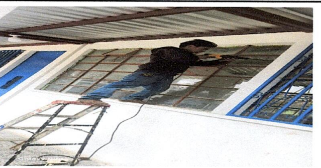
Foto 5: Sustrucción de vidrios
