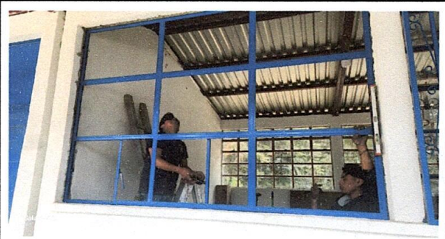
Foto 4: Sustrucción de estructura de metal de ventana
