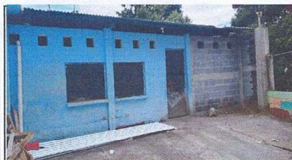
Foto 3: cambiar todo el techo laminas troqueladas
