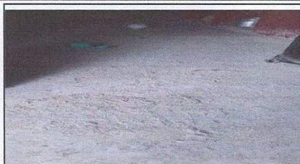
FALTA PISO DE GRANITO.
