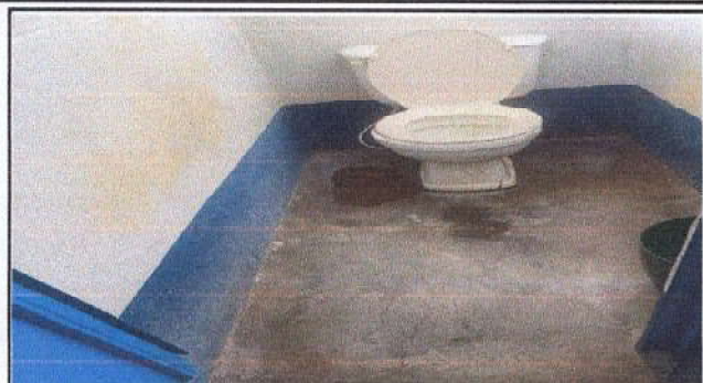
Foto 1: Servicios sanitario y sus accesorios
