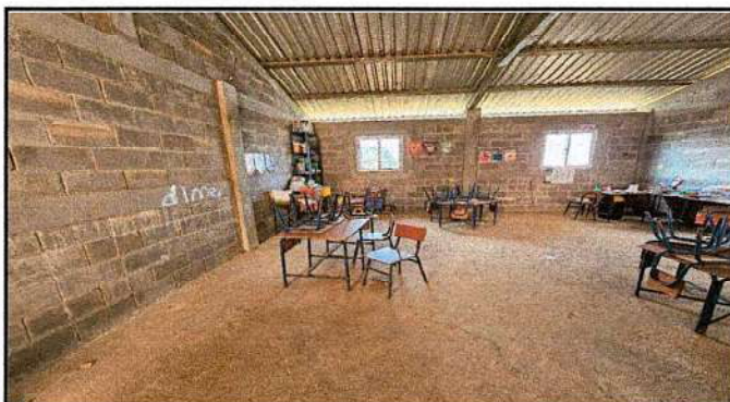
Foto 4: Repello en muros interior color gris y blanco
