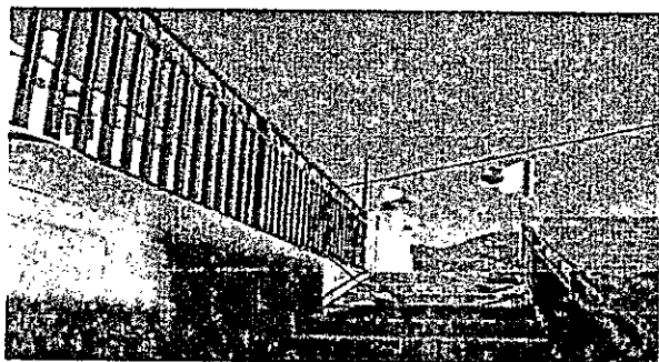
Foto 3: Baranda de metal
