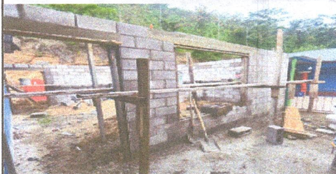
Foto 4: sin puertas y ventana
