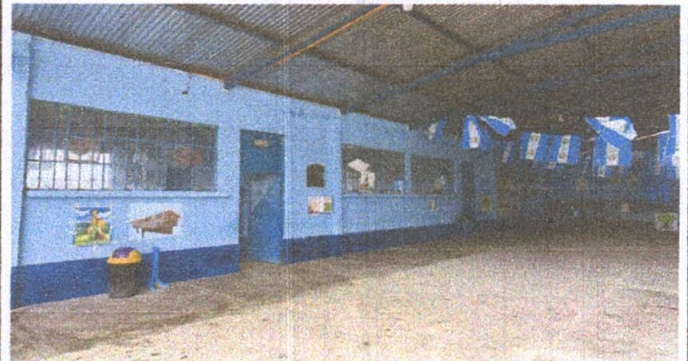
FOTO 4: Pintura en paredes
