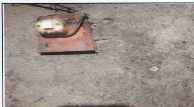
Foto 3: Apagador que ya no funciona
