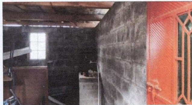
Foto 4: Interior de la cocina que hace falta repello
