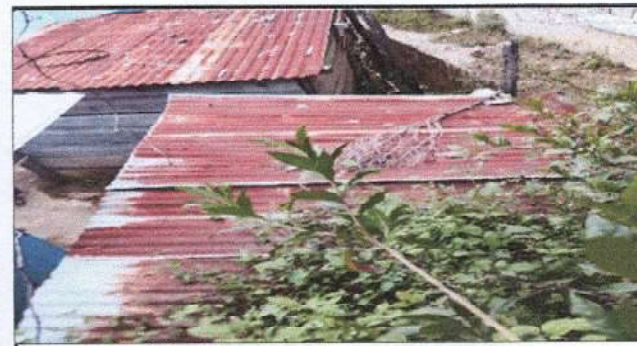
Foto 6: Techo de los baños de los niños.
