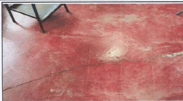
Foto 2: Piso que ya esta afectada.
