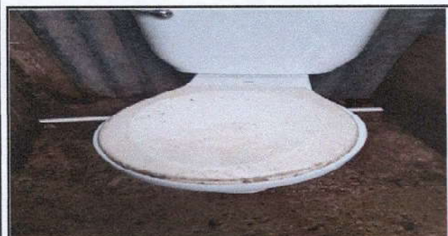
Foto 5: Inodoro que ya esta quebrado el de abajo.
