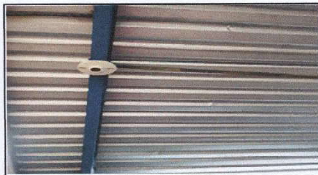
Foto 4: Hace falta focos
