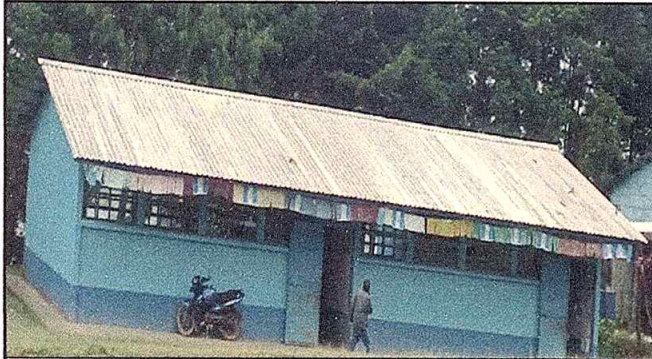
Foto1: Cambio de laminas por oxidacion y goteo.
