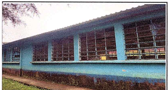
Foto 4: paredes despintadas, en mal estado y vidrios rotos.
