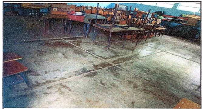
Foto 2: piso manchado y en mal estado.
