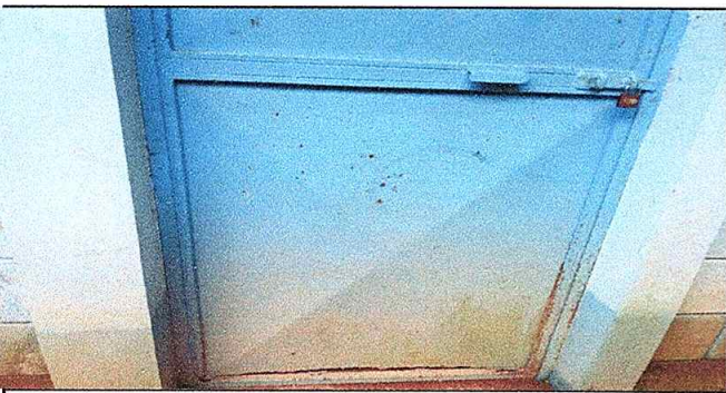
Foto 5: puertas deterioradas por oxido.
