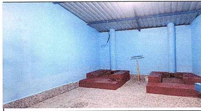
Foto 4: Sustitucion de estufa rural completa
