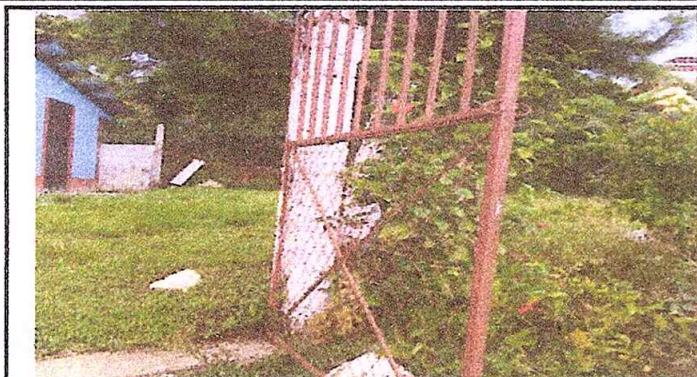
Foto 1: Sustitución de portón de metal (2.50m de alto*4m de ancho) Ya que se observa que se encuentra deteriorada
