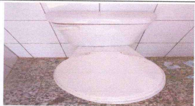
Foto 4: El la foto se observa que los inodoros se ecuentran en mal estados por lo que se cambiaran por inodoros nuevos.
