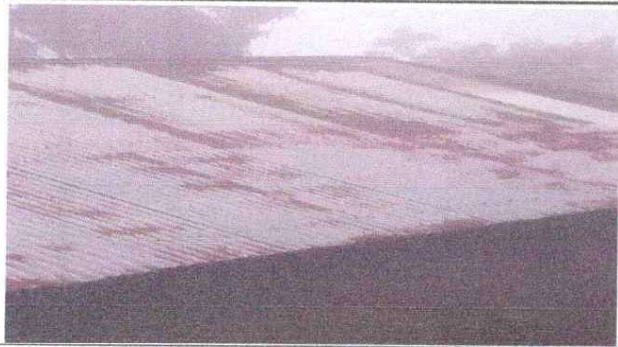
Foto 1: En la imagen se observa que la lamina de la cosina se ecuentra en mal estado, oxidado por lo que se cambiara por laminas troquelas
