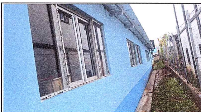
Foto 4: En esta fotografía se mira la parte trasera de las aulas en donde se ven ventanas en mal estado vidrios opacos y estructuras de metal oxidado.
