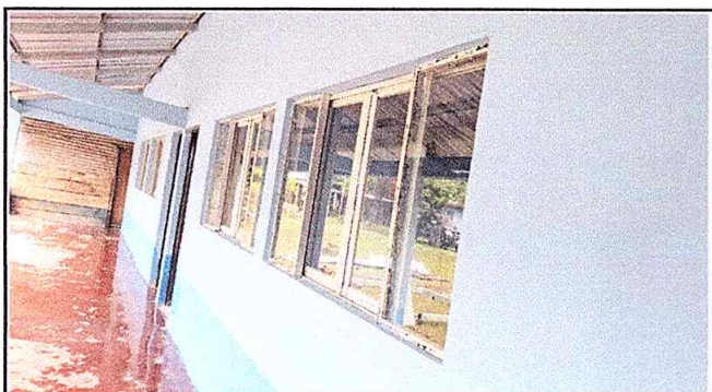
Foto 3: En esta imagen se puede analizar que las ventanas de las aulas ya están deterioradas las bases de metal y tanto los vidrios en frente y corredor de la escuela
