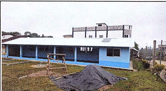
Foto 1: En esta imagen se observan las láminas oxidadas de la parte frontal de las aulas que se necesitan cambiarlas.
