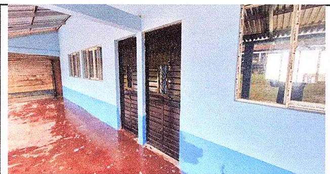
Foto 5: En esta imagen se ven puertas oxidadas y calcomidas de aulas que están en uso.
