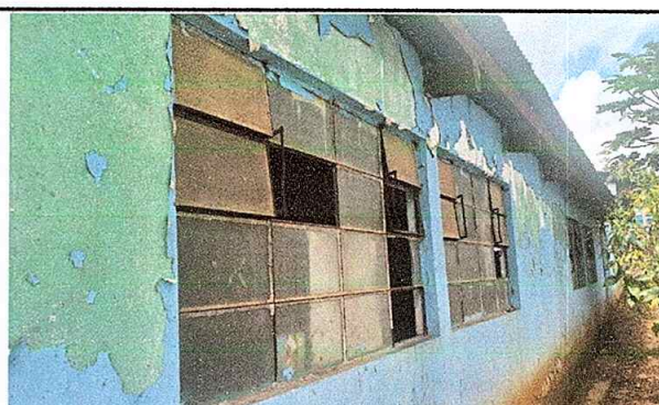
Foto 4: En esta fotografía se mira la parte trasera de las aulas en donde se ven ventanas en mal estado vidrios opacos y estructuras de metal oxidado.
