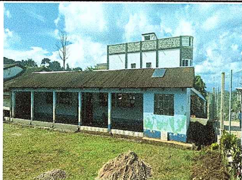
Foto 1: En esta imagen se observan las láminas oxidadas de la parte frontal de las aulas que se necesitan cambiarlas.
