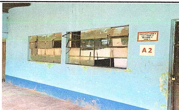
Foto 3: En esta imagen se puede analizar que las ventanas de las aulas ya están deterioradas las bases de metal y tanto los vidrios en frente y corredor de la escuela
