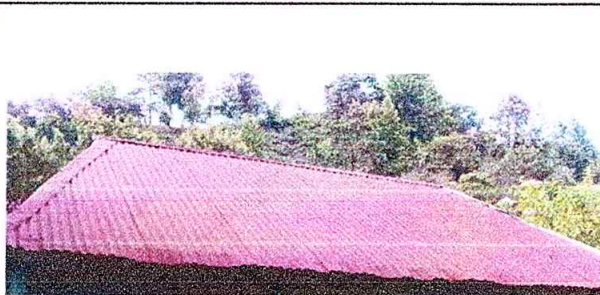
Foto 1: Cubierta de lámina en mal estado.
