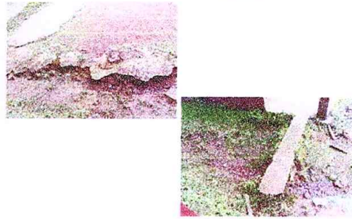
Foto 4: Losa de patio y pasillo en mal estado
