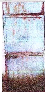
Foto 5: Puertas metálicas deterioradas.
