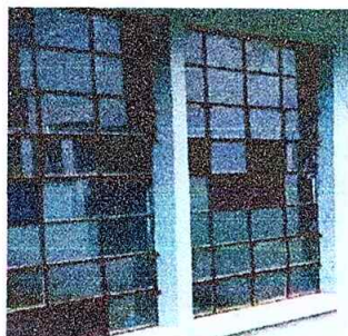
Foto 3: Ventanas y vidrios quebrados.
