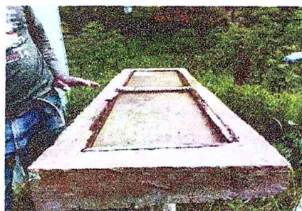
Foto 6: Lavamanos en mal estado.
