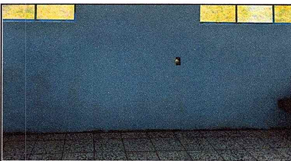
Foto 6: Repello en paredes
