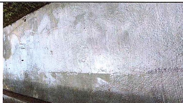
Foto 3: Reparación de patio de la escuela en mal estado
