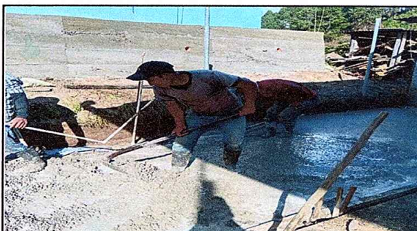
Foto 3: Reparación de patio de la escuela en mal estado,
