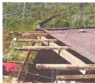
Foto 2: En la imagen se observa que el techo es de madera se encuentra en malas condiciones, se cambiará por soporte de metal
