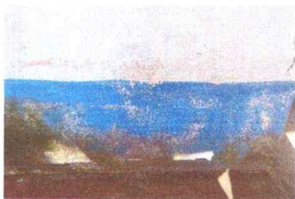
Foto 7: en la imagen se observa que las paredes están en mal estado , se hará mantenimiento en paredes con pintura
