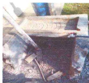
Foto 10: la pila no está en uso por malas condiciones, se cambiará por una pila de cemento de dos lavaderos
