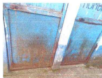
Foto 4: en la fotografia se observa las puertas del baño se encuentran oxidadas, y en malas condiciones por lo que se cambiarán.
