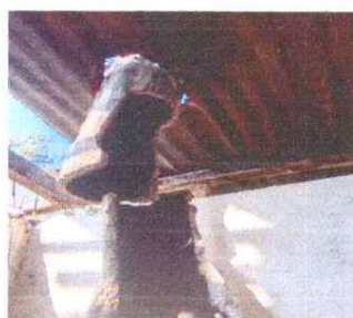
Foto 11: la chimenea ya no sirve, malas condiciones, por lo cual se cambiarán por nuevas chimeneas .
