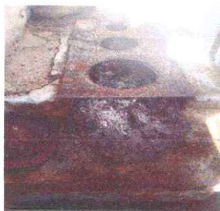
Foto 9: en la fotografía se observa que el horno está en malas condiciones, se cambiará por una placa de metal de 3 hornillas
