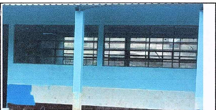
Foto 5: las ventanas ya van mejorando con el mantenimiento que se le está haciendo
