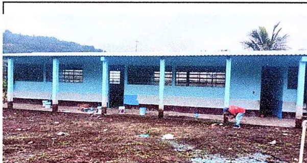
Foto 7: Es necesaria la pintura en muros exteriores
