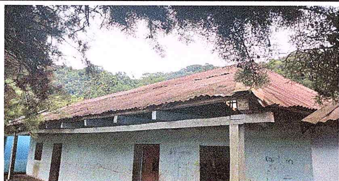
Foto 1: en la fotografía podemos observar que es necesario cambiar las laminas que la escuela actualmente tiene.
