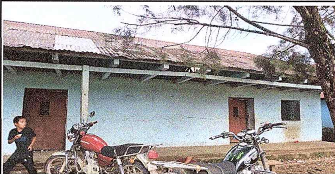
Foto 7: Es necesaria la pintura en muros exteriores
