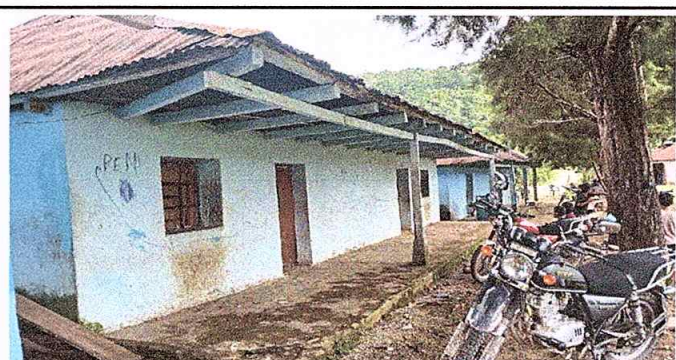
Foto 4: es necesario sustituir el piso de la escuela por piso de granito
