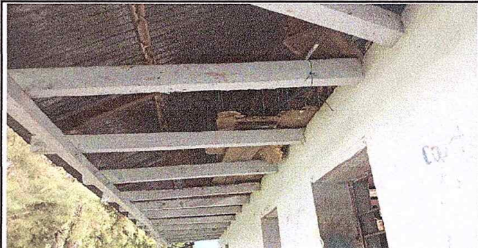
Foto 2: en la fotografía se puede observar el deterioro de las vigas de maderas y es necesario cambiarlos
