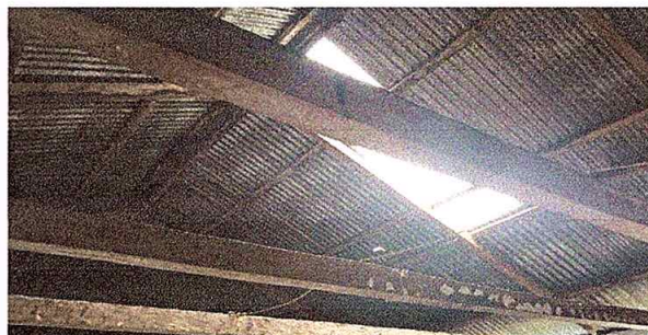
Foto 8: en la fotografía se puede observar el deterioro de la estructura de soporte de madera y es necesario cambiarlas
