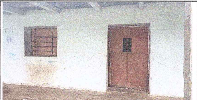
Foto 6: en la fotografías se puede apreciar el deterioro de las puertas del establecimiento por lo que es necesario sustituirlas
