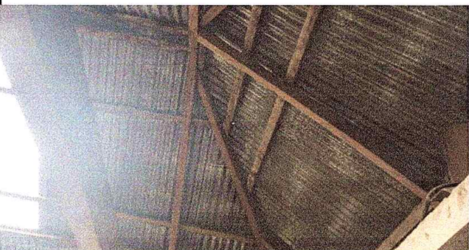
Foto 9: el deterioro de las reglas que están de soporte dentro y fuera de las aulas están en deterioro
