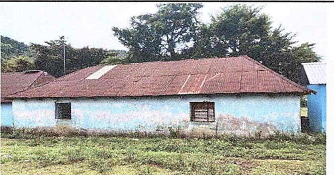
Foto 5: en la fotografía se puede ver que hay necesidad de sustituir las ventanas del establecimiento
