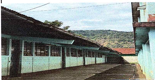
Foto 3: Pinturas muy deterioradas.
