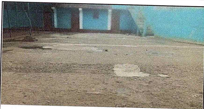
Foto 3: Piso en mal estado
