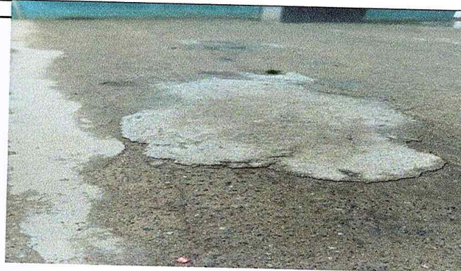
Foto 4: Piso en mal estado
