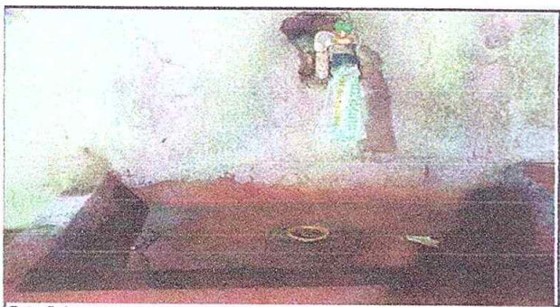
Foto 5: lavamanos en mal estado
