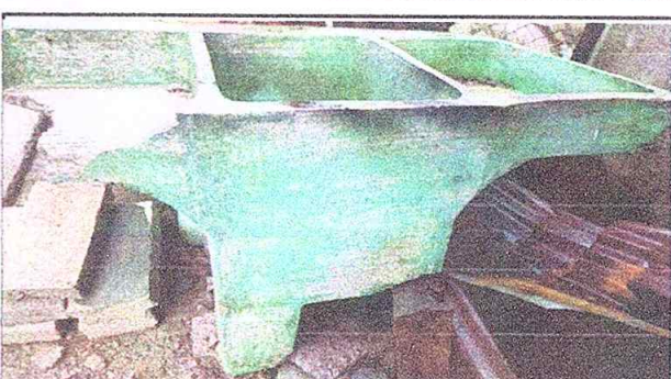
Foto 4: pila de cemento deteriorada
