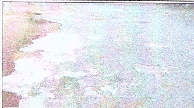
Foto 1: piso de patlo en pesima condición
