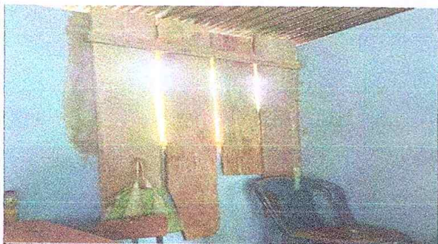
Foto 3: ventana de cocina en mal estado
