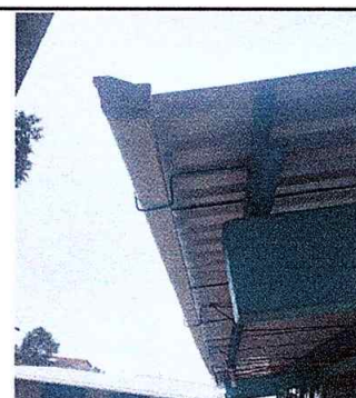
Foto 18: Mejoramiento con soporte o pescante de metal
