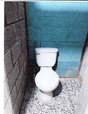
Foto 8: Sustrucción de inodoro
