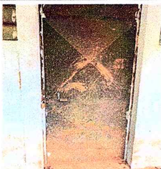
Foto 5: En la imagen se observa las puertas de las aulas en muy mal estado rota y oxidada.
