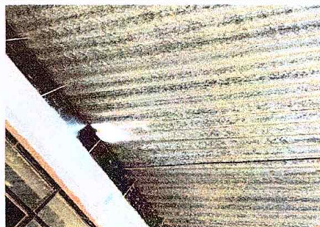
Foto 4: en la imagen se observa que la lamina del techo se encuentra agujerada y entrada de agua .
