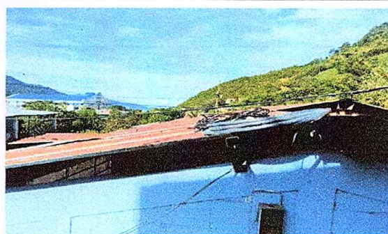
Foto 2: En la imagen se observa el techo deteriorado e inservible
