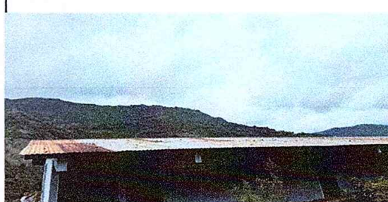
FOTO: 6. el techo de la escuela se encuentra en mal estado la lamina oxidada y rota
