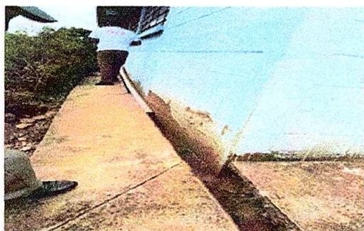
Foto 3: En esta imagen se observa una torta de piso agrietada y necesita ser reconstruida y mantenimiento
