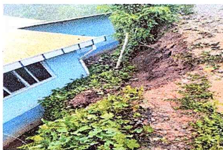
Foto 2: En la fotografía se observa el canal de agua pluvial roto y en malas condiciones
