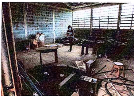
Foto 1: En esta imagen se observa en el interior del aula con vidrios de ventanas quebradas y se necesita cambiar.
