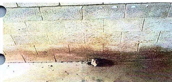
FOTO: 5 En la imagen se observa la pared de las aulas en muy mal estado
