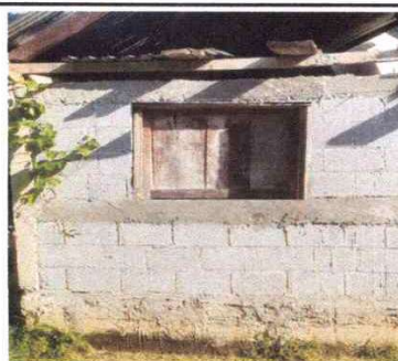
Foto 4: En la imagen se observa que la venta es de madera y en malas condiciones al cual se cambiara por ventanas de marco de metal más vidrio en la cocina y aula.
