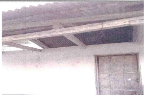
Foto 1: En la imagen se observa que la lámina se encuentra rota y oxidada y la estructura portante es de madera, por lo que se cambiara lámina por lámina troquela Aluzinc y costaneras.
