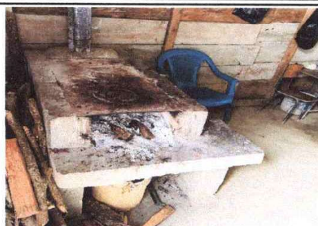
Foto 8: En la imagen se observa que la plancha y la chimenea se encuentra en mal estado, a la cual se va a sustituir por nuevas.
