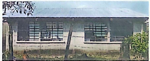
Foto 4: Pinturas en muros exteriores y ineriores
