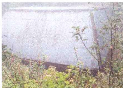
Foto1: Sustrucción de lámina en mal estado y con agujeros en la cocina
