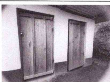
Foto 4: Sustrucción de puertas del baño de madera deteriorada
