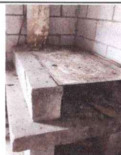
Foto 6: Sustrucción de estufa rural en malas condiciones, chimenea deteriorada y plancha oxidada
