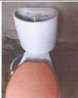
Foto 9: Sustitución inodoro en mal estado
