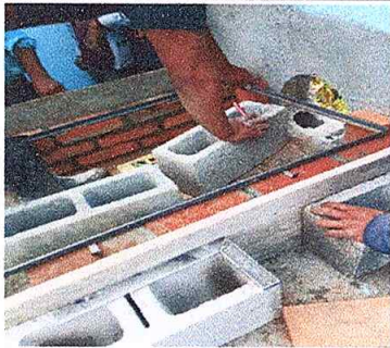
Foto 1: Durante la sustitución de estufa rural (completa) incluye chimenea y planta de metal
