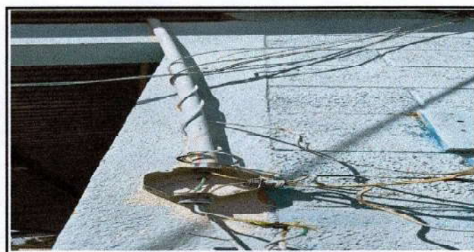
Foto 6: Sustrucción de ducto eléctrico + accesorios
