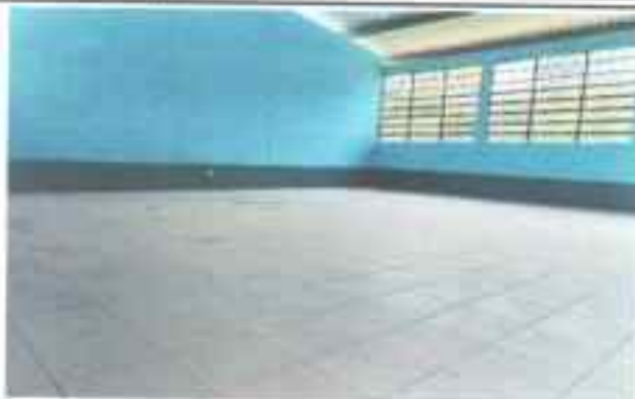
Foto 1: piso de cemento sustituido por piso de granito
