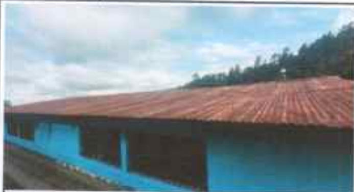
Foto 1: Lámina en malas condiciones
