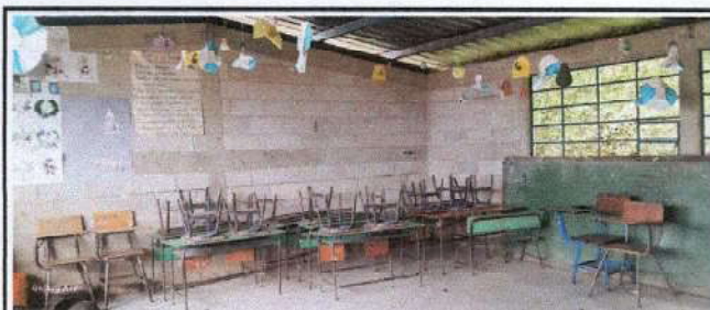
Foto 5: aulas sin repello y muros de pared sin pintura
