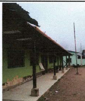
Foto 6: canales de drenaje deteriorados
