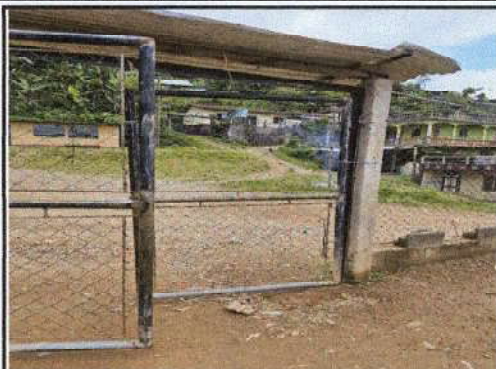
Foto 1: Portón de metal en mal estado
