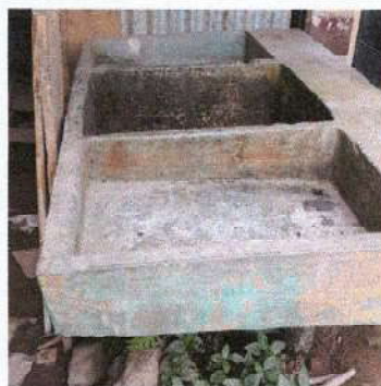
Foto 4: pila de cemento deteriorada
