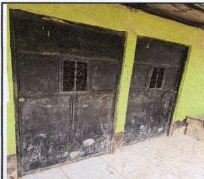
Foto 3: puertas de metal en mal estado
