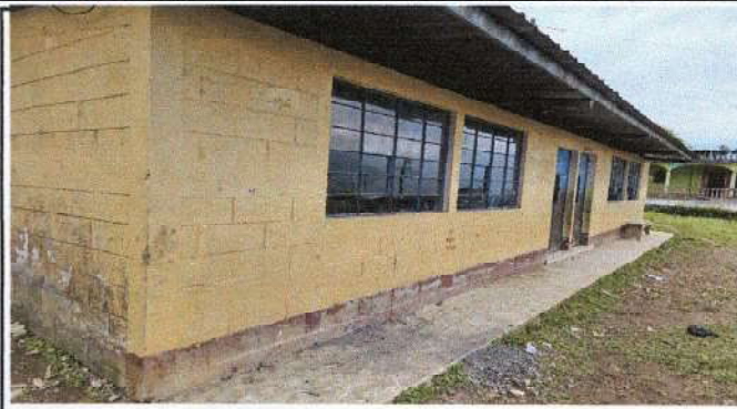
Foto 2: Balcones de ventana y vidrios rotos
