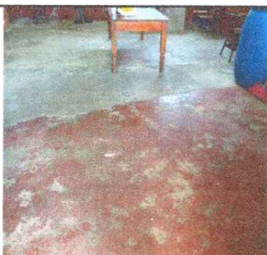
Foto 3: se aprecia el deterioro del piso y se sustituya por piso de granito.
