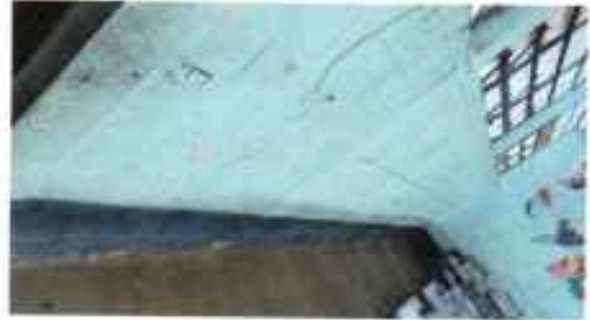
Foto 8: Repello en paredes
