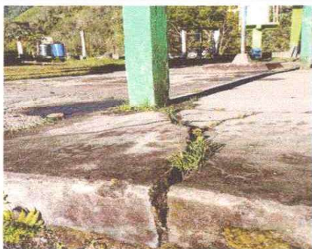
Foto 3: Torta de cemento rajada por el paso del tiempo
