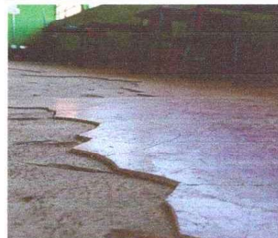
Foto 2: Piso en aulas en mal estado por el paso del tiempo
