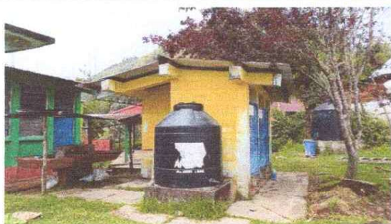
Foto 5: Depósitos de agua en mal estado
