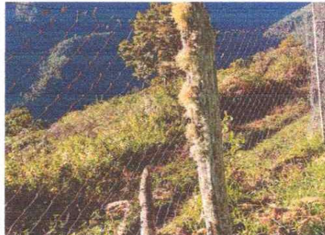
Foto 4: Malla y alambre de púa en mal estado
