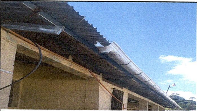
Foto 3: parte de en frente no cuenta con canal ni bajada de agua, afectando la pared por humedad.
