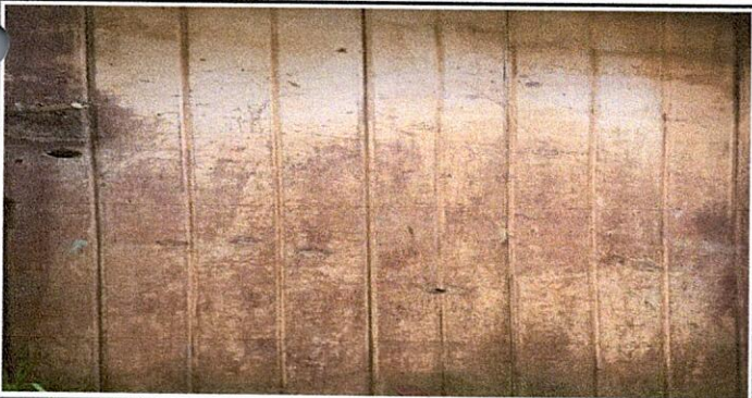
Foto 5: puerta en mal estado
