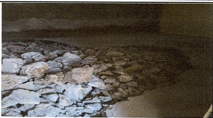
Foto 2: vista del piso rajado necesita reparación.
