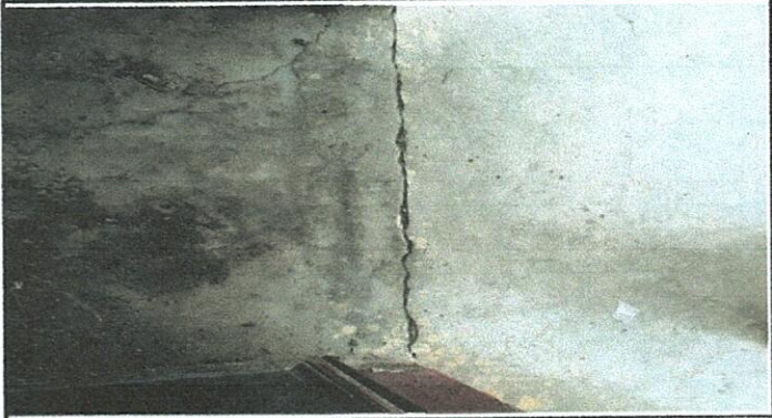
Foto 2: vista del piso rajado necesita reparación.
