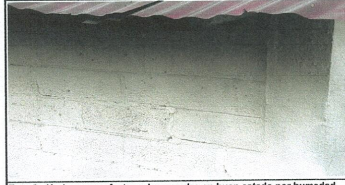
Foto 6: láminas que afectan a las paredes en buen estado por humedad.
