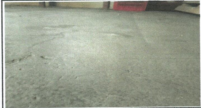
Foto 4: piso en mal estado.
