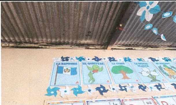
Foto 3: Laminas y estructura de soporte en mal estado.
