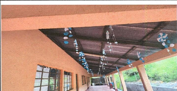
Foto 4: Laminas y estructura de soporte en mal estado.
