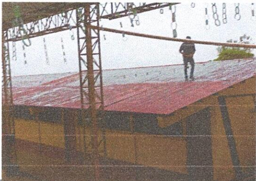
Foto1: En la imagen se aprecia lámina a cambiar po lámina troquelada
