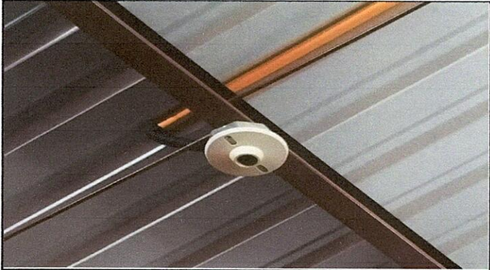
Foto1: plafoneras en malas condiciones.
