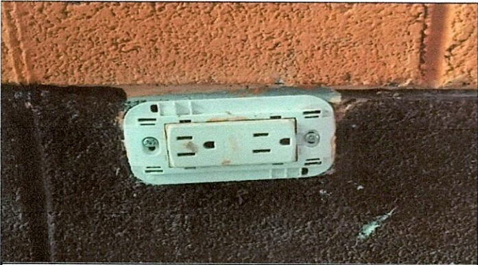
Foto 3: tomacorrientes en malas condiciones.
