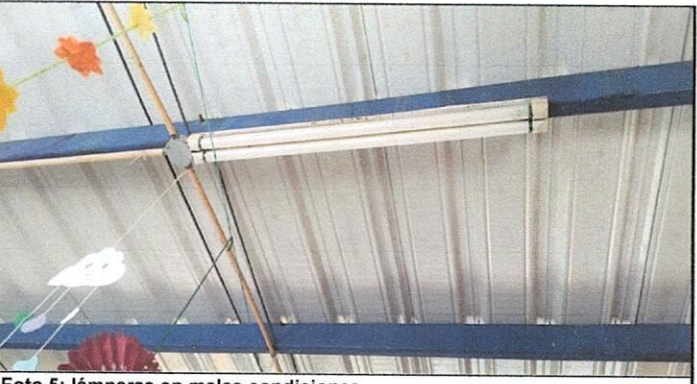
Foto 5: lámparas en malas condiciones.
