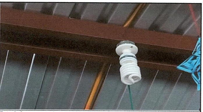
Foto 6: focos en malas condiciones.
