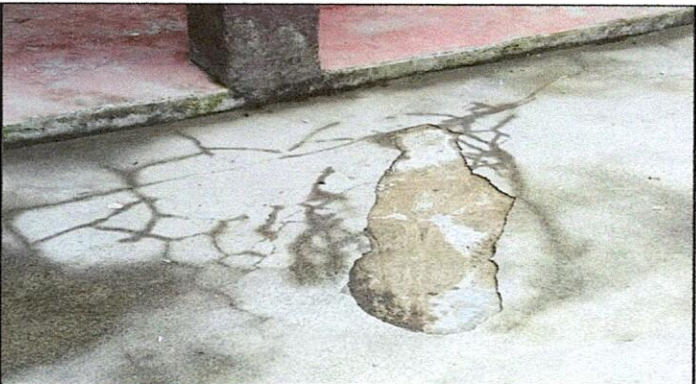
Foto 4: piso de torta en malas condiciones.
