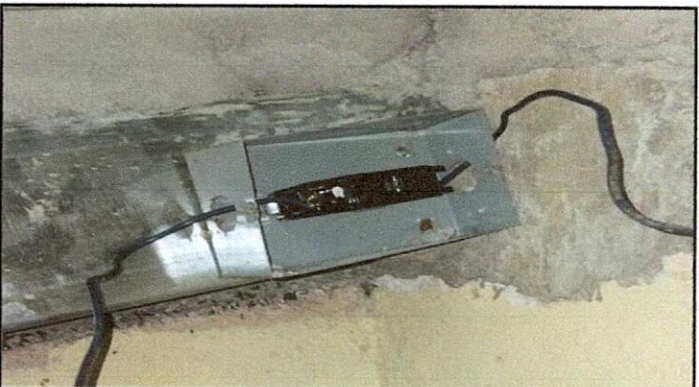
Foto 4: plifón en malas condiciones.
