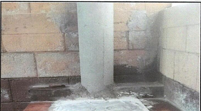
Foto 2: chimenea en malas condiciones.
