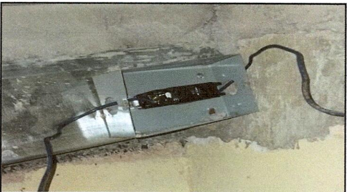
Foto 4: plifón en malas condiciones.
