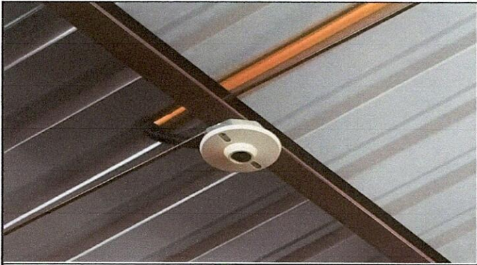
Foto1: plafoneras en malas condiciones.
