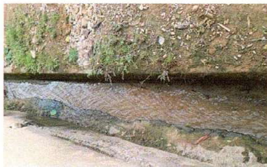
Foto 2: Cuneta extremadamente deteriorada por el paso de los años
