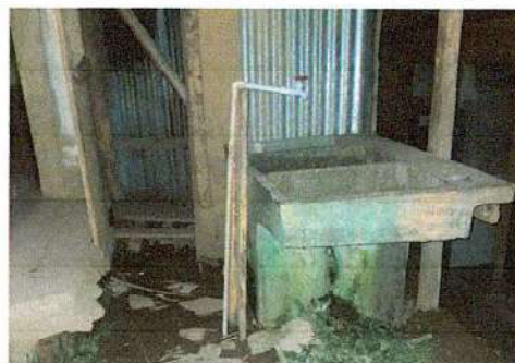
Foto 4: Pila sin funcionamiento debido a filtraciones por deterioro por el pasar de los años
