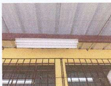
Foto 4: Sustrucción sistema eléctrico
