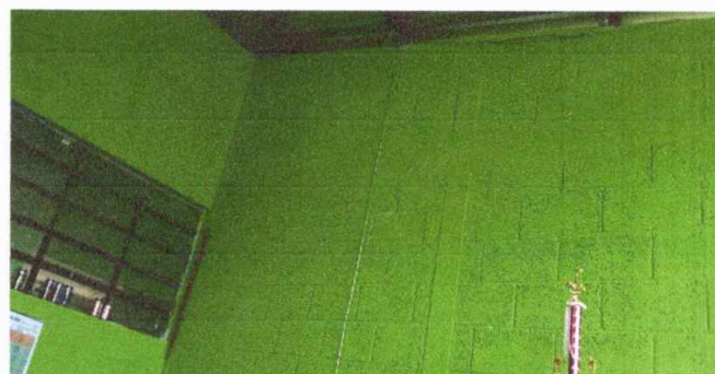
Pintura en paredes
